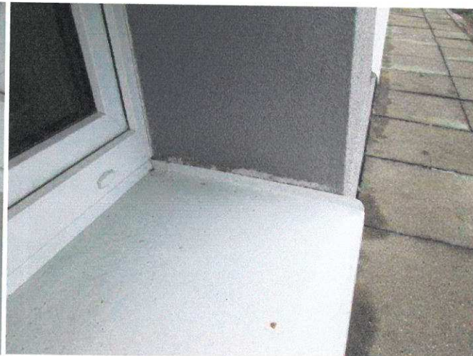
foto /22/ Parapet suterénního okna západní fasády – bílé výkvěty u ostění okna
