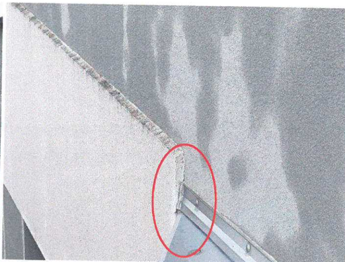
foto /10/ Trhlina v napojení oplechování
