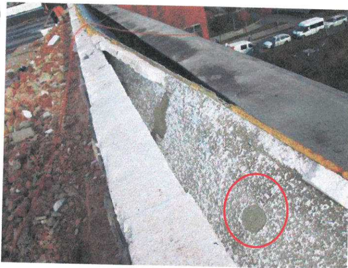
foto /33/ Vnitřní líc základní vrstvy (po ubourání zdiva atiky) s nadměrným množstvím stěrkové hmoty v místě kotvy
