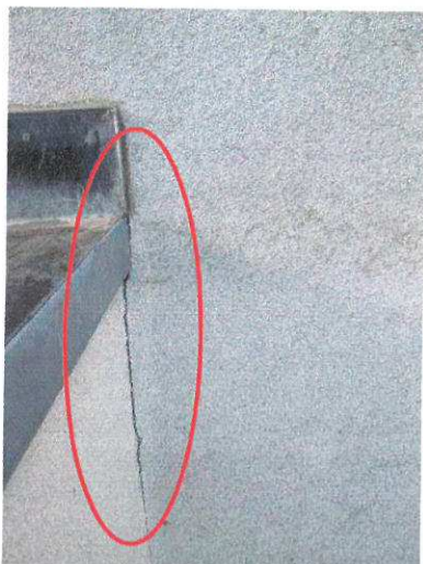
foto /39/ Detail styku stěny krčku a východní fasády předmětného objektu – svislá trhlina
