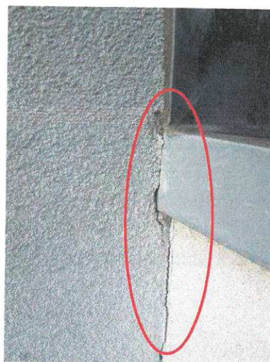
foto /38/ Detail styku stěny krčku a východní fasády předmětného objektu (u střechy krčku) - trhlina
