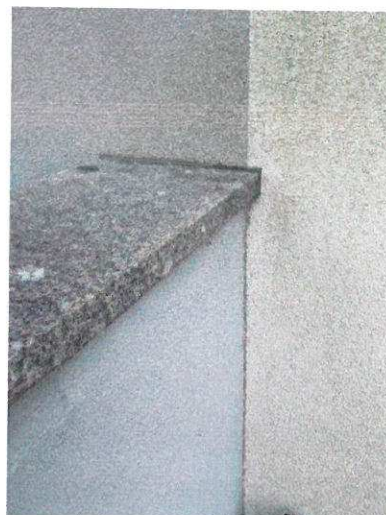
foto /26/ Svislá trhлина v omítce mezi zábradlím a severní fasádou
