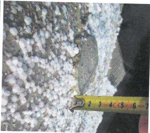
foto /34/ Detail stěrkové hmoty vyznačené na foto /33/ - signalizuje zapuštění kotvy, v daném případě o cca 8-9 mm
