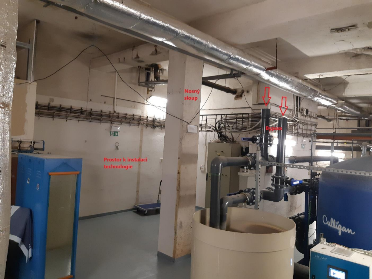
Foto bypassu a připraveného prostoru pro instalaci technologie
